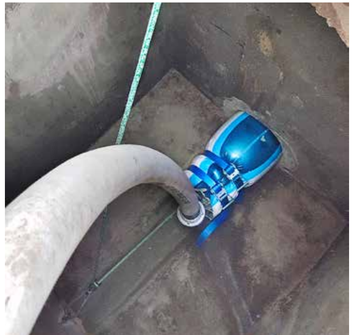
Schauinliner in einem Schacht
